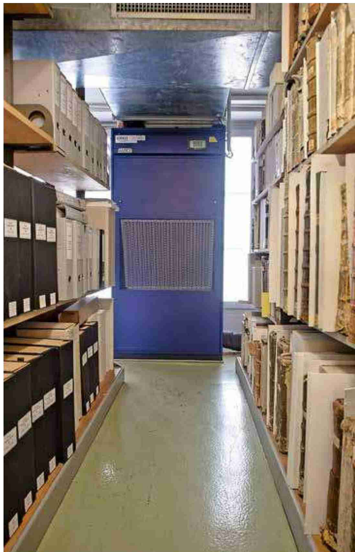
Die Klimaanlage ist derzeit gerade ausgestiegen.
